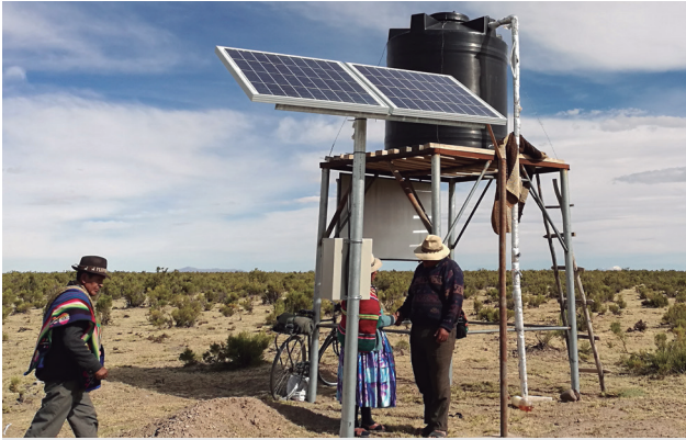
Figura 6.9. Sistema fotovoltaico en Turco. Fuente: fotografía de Paula Pacheco M.
